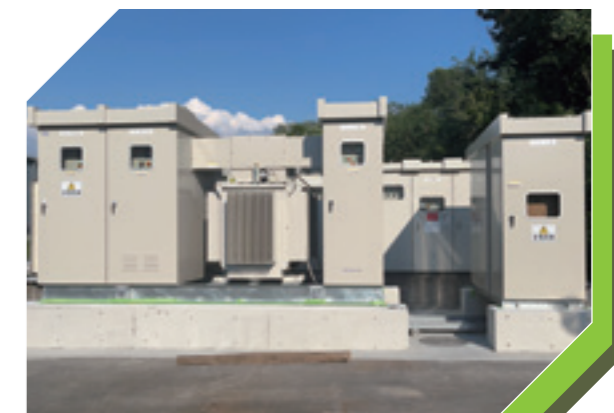
大阪某所、受変電設備と VCT 盤納入実績
