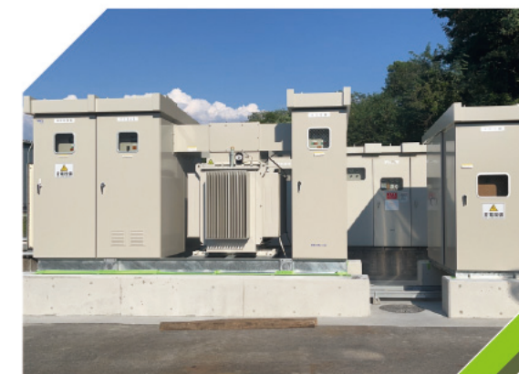
大阪某所、受変電設備と VCT 盤納入実績
